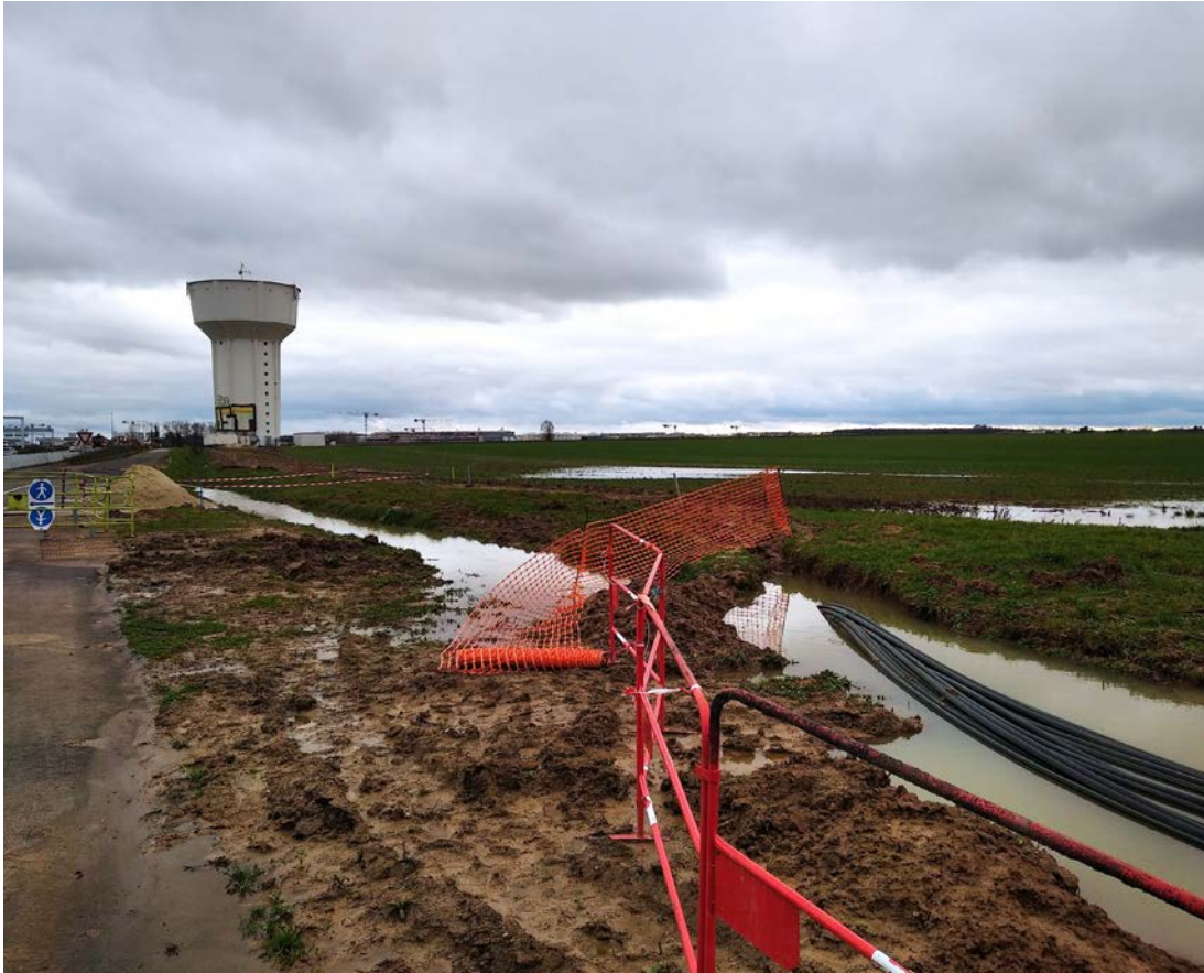
Chantier sur le plateau de Saclay : Problèmes de drains 02/2021 ©Terre & Cité
