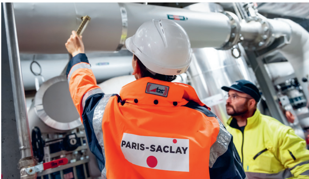
Dans l'installation centralisée du réseau de chaleur et froid, quartier de Moulon
